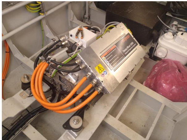
Nouveau moteur électrique de propulsion
