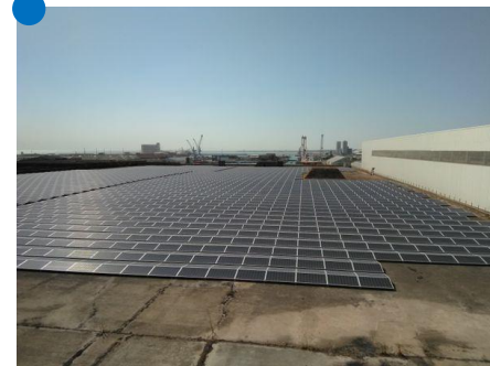
Centrale solaire sur toiture en zone portuaire
